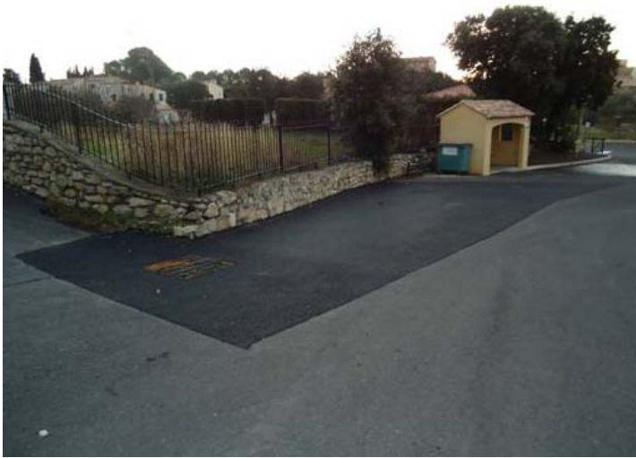
Reprise de la voirie réalisée en 2008 et mise en conformité d'une bouche d'eau, suite à un défaut de réalisation du réseau pluvial : travaux réalisés à la charge de l'entreprise.
