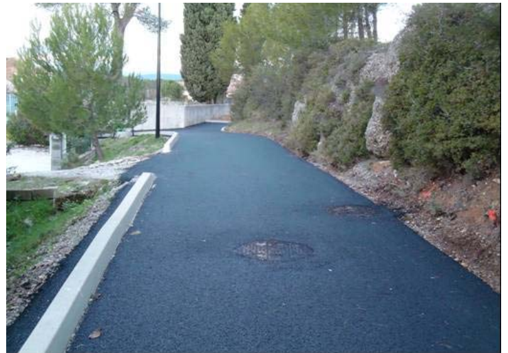
Réhabilitation du chemin du cimetière en enrobé avec bordure de propreté, afin de faciliter le passage de la balayeuse.
